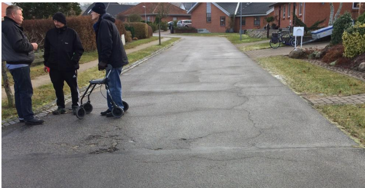
Foto 1: Eksempel på omfattende svindrevner og krakeleringer. Både asfaltslid- og bærelag er hærdet så meget, at der opstår tværgående svindrevner med få meters mellemrum. Disse er forbundet med langsgående revner, så der generelt opstår grov- hhv. finmasket krakelering og belægningsnedbrud. (foto: Vejafsnit B2).
