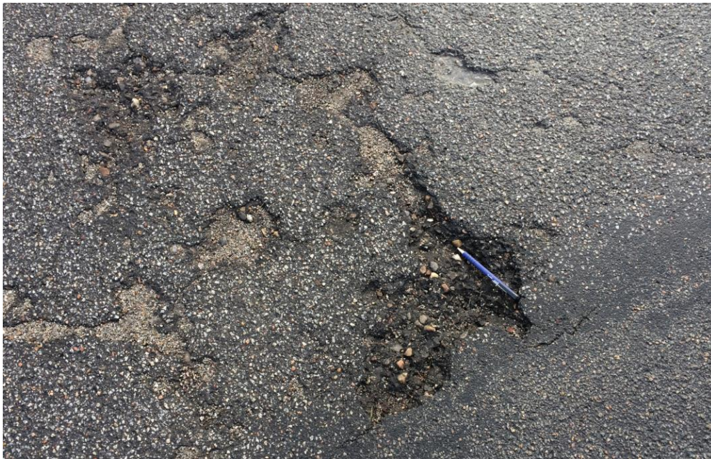
Foto 2: Det ses ved slidlagsafskalningen at det gamle slidlag er ganske tyndt, skønmæssigt kun ca. 1 cm, og at det underliggende GAB asfaltbærelag består af rundkornede grusgravsmaterialer med indhold af kalk- og flintesten. Lagtykkelsen af GAB-laget er ukendt.
