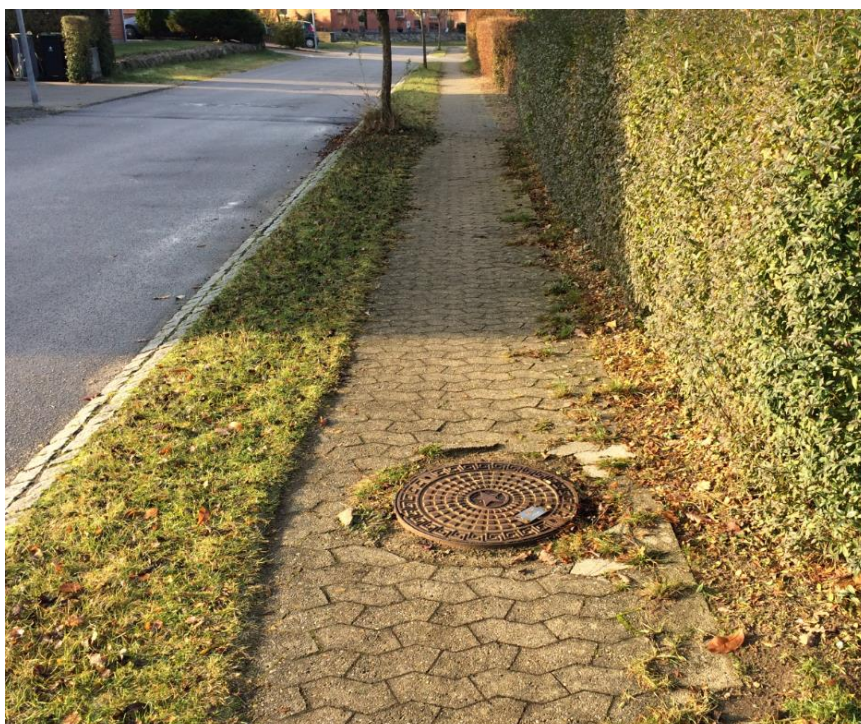
Foto 15: De steder, hvor der er fortove med belægningssten, bærer fortovene også tydeligt præg af at belæggningerne er ca. 35 år gamle, ujævne og med stedvise opskubninger/sætninger.
