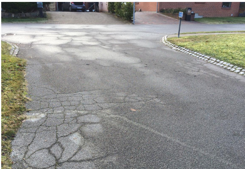
Foto 4: Eksempel på omfattende krakeleringer (Stikvej B6 set mod B2).
