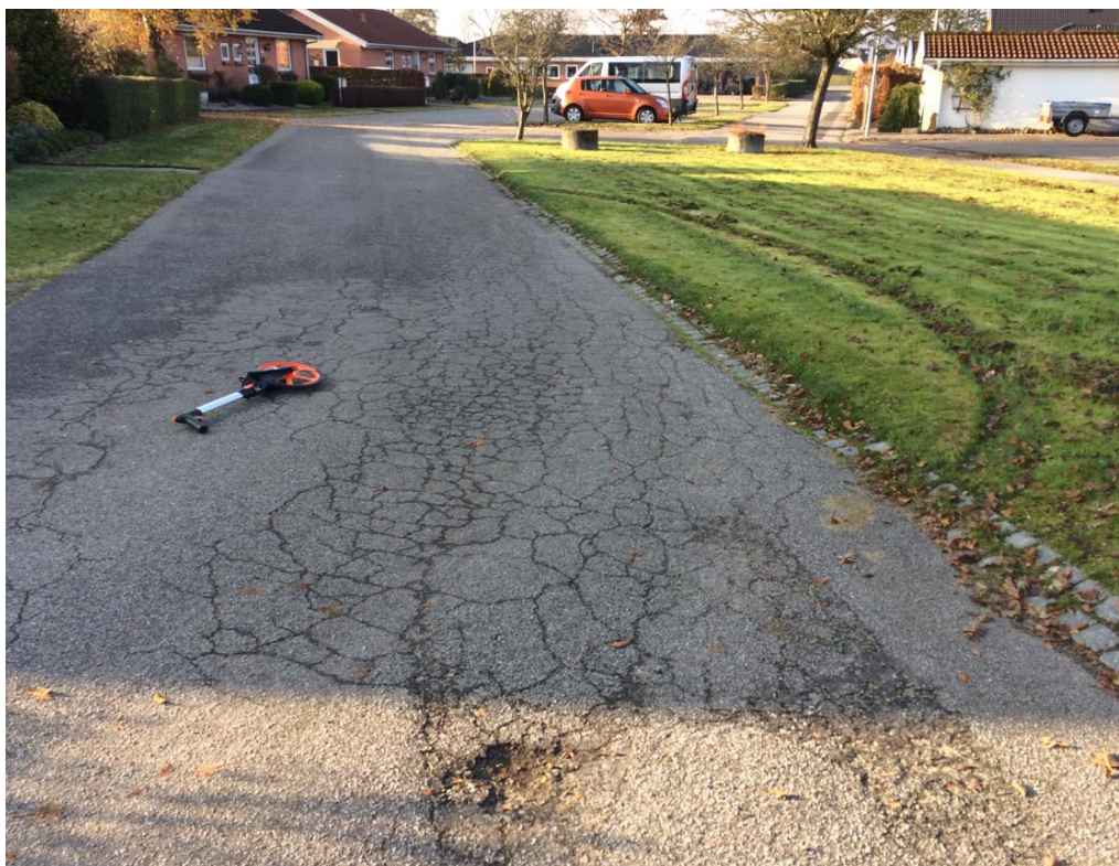
Foto 6: Eksempel på meget omfattende krakelering og begyndende slag hul (Delomr. C7).
