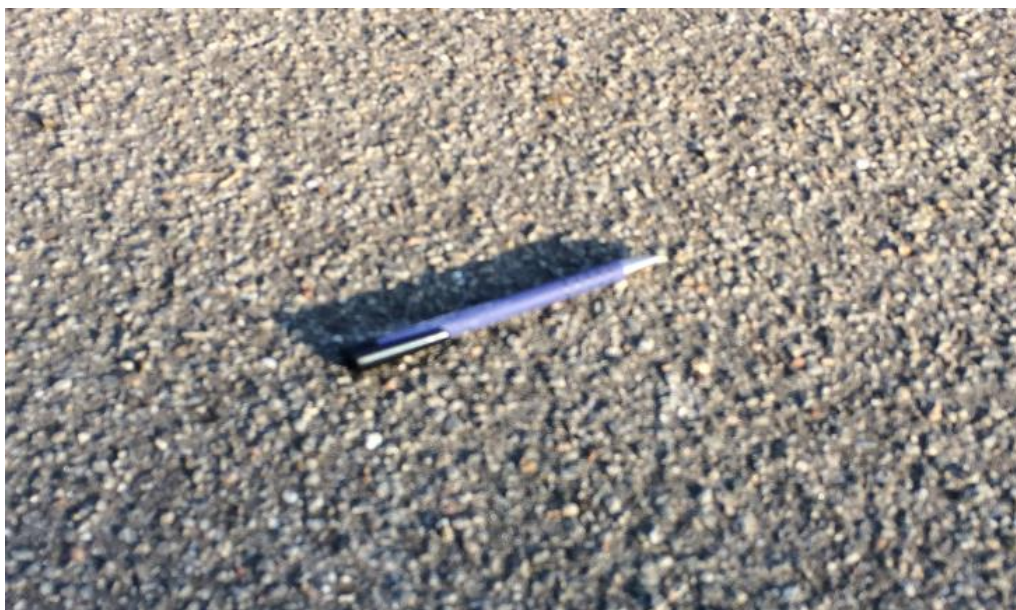
Foto 11: Slidlagsbelægningen er generelt gammel, "træt" og udtørret i overfladen. En emulsionsforsegling på et væsentligt tidligere tidspunkt ville givetvis have gjort underværker for holdbarheden.
