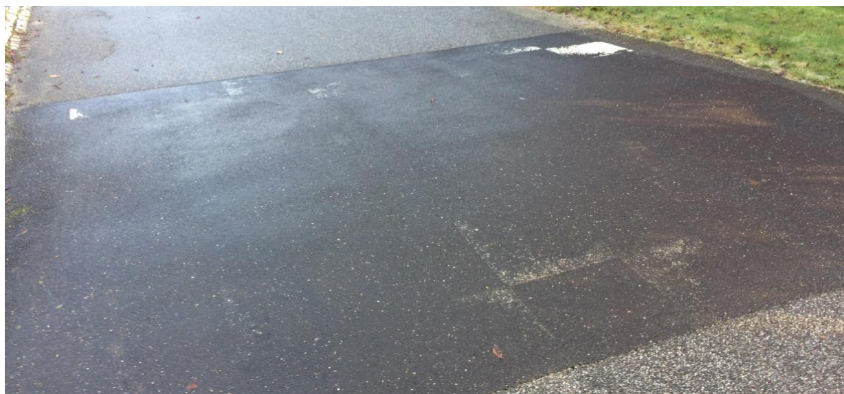
Foto 13: Eksempel på afslidt, reelt ikke-eksisterende vejbump-trafikmarkering (delomr. D2)
