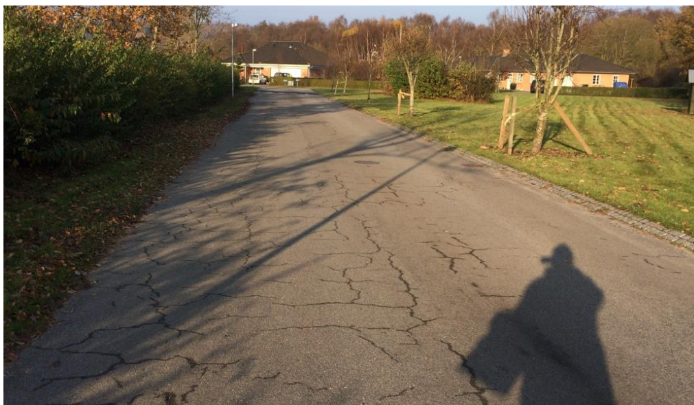
Foto 8: Nordligste del af stamvejen: Under optørrende vejr træder det meget omfattende krakelermønster frem og viser, at belægningen er under omfattende nedbrydning.
