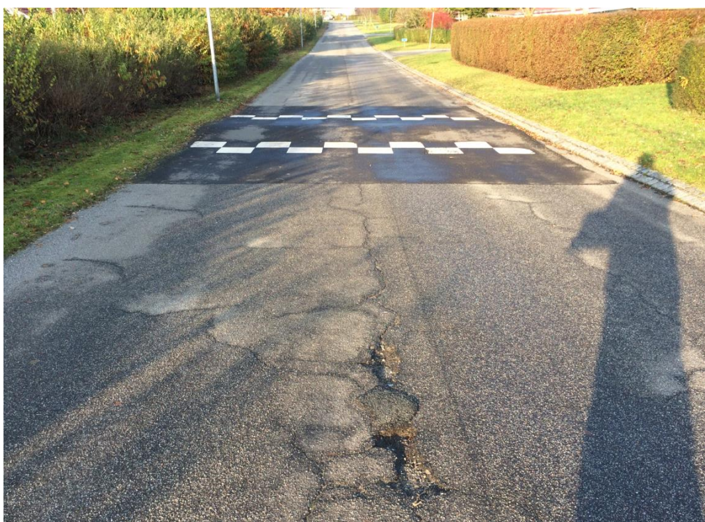
Foto 7: Stamvejen set fra B2 mod nord: Meget omfattende krakelering og belægningsnedbrud med slag huller. Det ser endvidere ikke ud til, at de relativt nye vejbumps "nedslagsområder" (hvor bilhjulene rammer vejen efter at have passeret vejbumpene) er blevet forstærket, som det ellers anbefales i vejreglen for vejbump.
