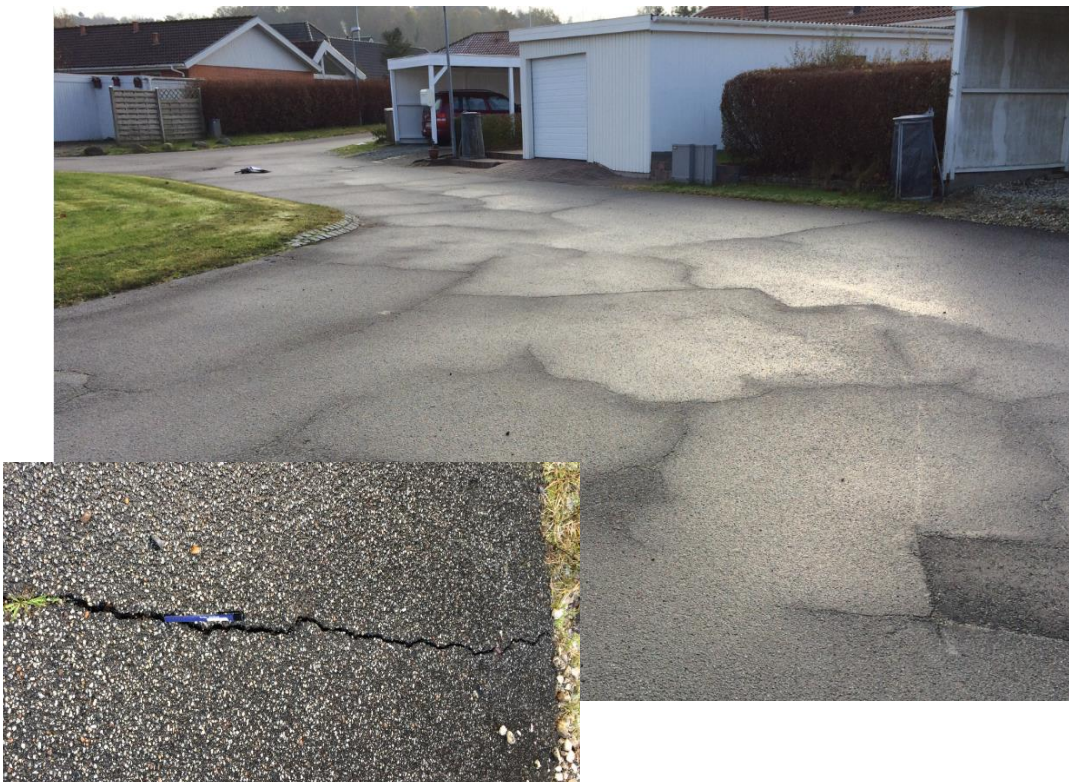
Foto 3: Omfattende plade-revne-mønstre (grovmasket krakelering) på stikvej B6. Mellem de tydelige grove revner findes finere mellemrevner, som ikke ses tydeligt på billedet, grundet manglende optørring af vejoverfladen ved fototidspunktet. Indsat udsnit viser revnebredde på ca. 1 cm (kuglepennebredde).
