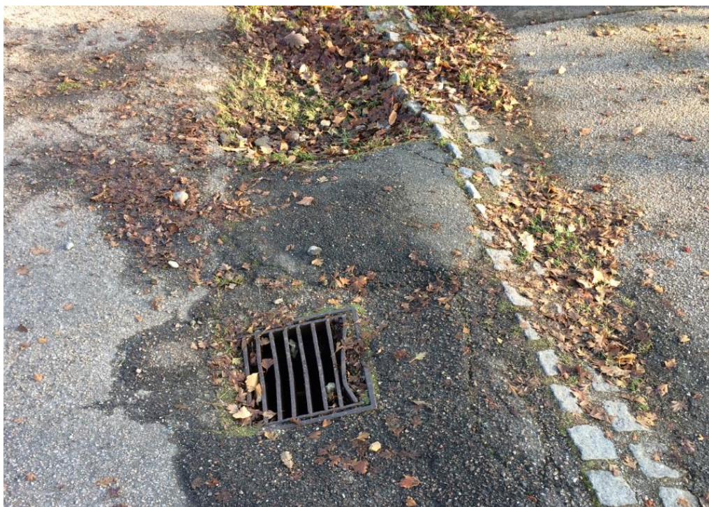
Foto 14: Mange steder har både brønde og chaussesstensborter sat sig. Ved mange af nedløbsbrøndene kunne endvidere konstateres, at vandspejlet i bunden af brønden stod skråt forskudt i forhold til ristens placering, hvilket indikerer, at brønd og/eller stikledning har sat sig eller er forskubbet og derfor givetvis kræver opfølgning/udbedring.
